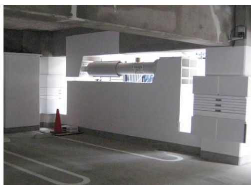
免震装置と減衰装置の設置状況
